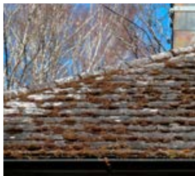
Taket täcks av ett grått skivmaterial/fibercement lagt med fjälltäckning. Genom åren har mosspåväxten blivit alltför kraftig, vilket binder fukt till taket.
